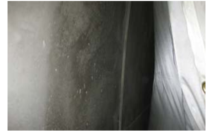
写真-4 散水1日後の覆工表面
