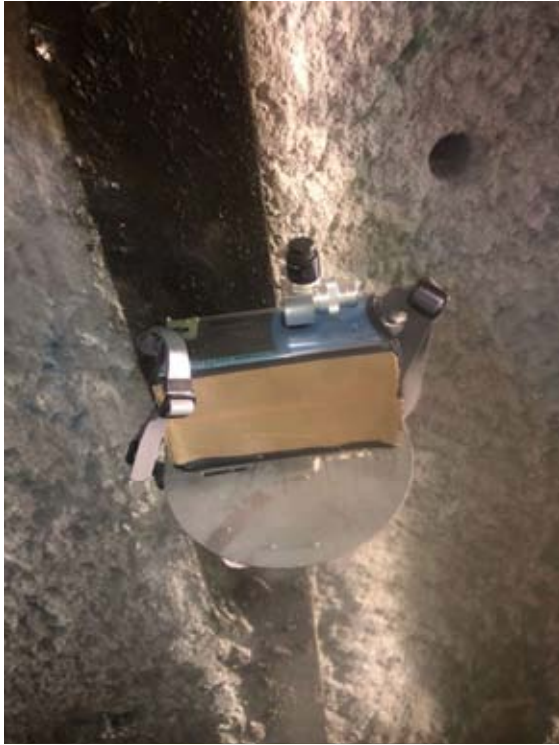
粉塵計取り付け架台
